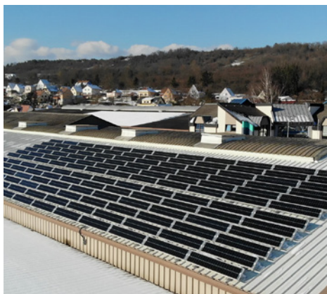
Installation BE-LIGHT de 17,3 kW sur une toiture de site industriel
