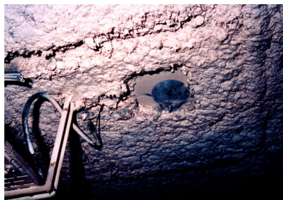
Flocage d'amiante © B.Floret / INRS
