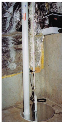
Système de dépressurisation des sols
