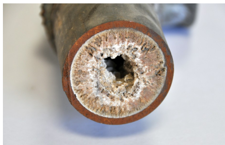
Tuyau obstrué par du calcaire
