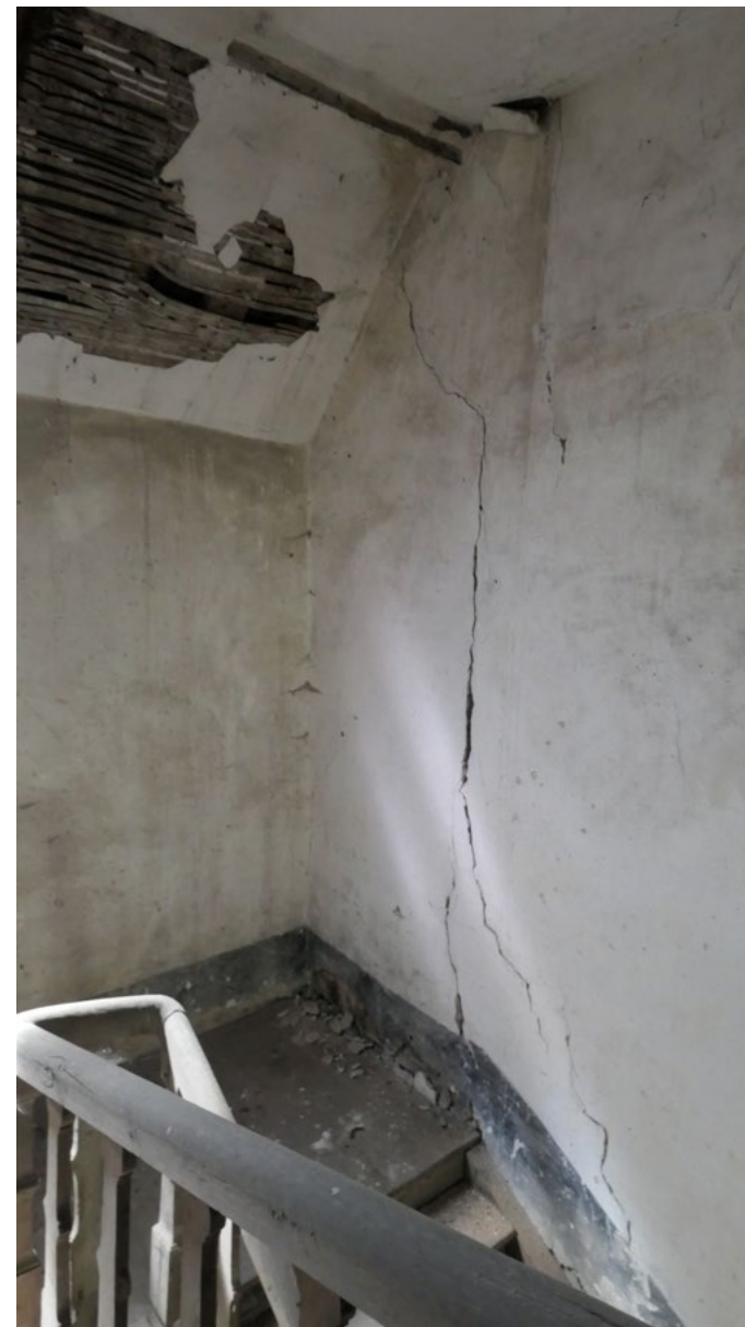
Désordres repérés lors du diagnostic © Stéphanie Honnert Architecte
