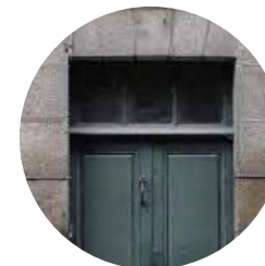
Ventilation par impostes
