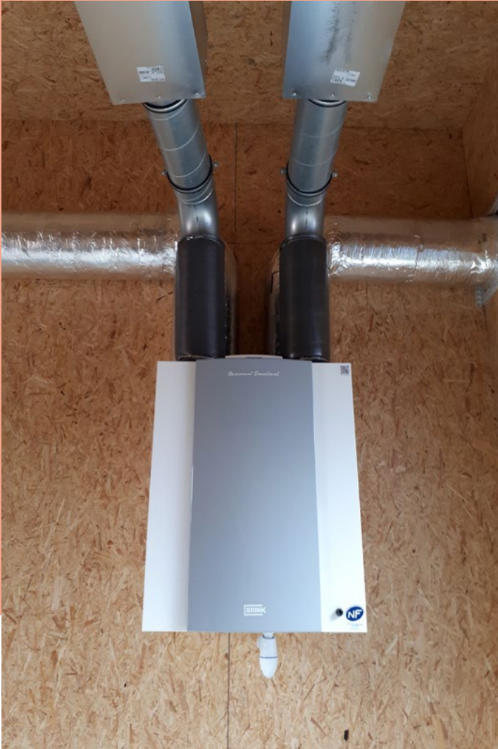
Système de ventilation dans un logement © AQC
