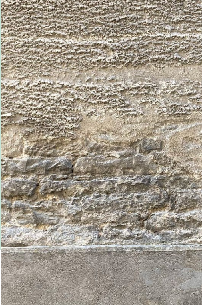
Cloquage des enduits lié aux remontées capillaires, Ornans (25) – © Ajena
