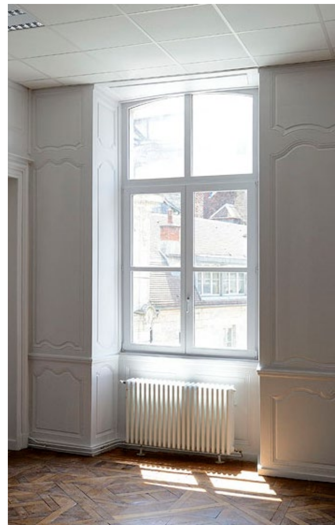
Radiateurs intégrés – 6, rue de la Madeleine à Besançon (25) © Nicolas Waltefaugle Architectes : Lefranc-Corbet-Friant et Tempesta
