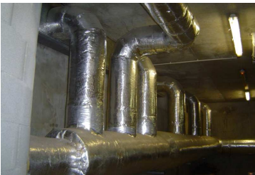
Isolation rapportée sur un réseau circulaire
