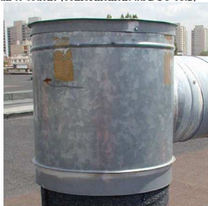
Figure 51 : Fermeture du té-souche avec des vis uniquement (étanchéité insuffisante)
