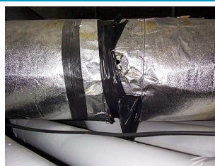
Isolation sur un conduit de soufflage, perforation pour mesurage de débit, non obturée (trou de 1 cm de diamètre)
