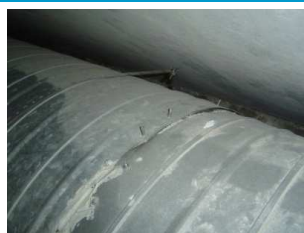
Jonction mal finie avec fuite, mastic non homogène ...
