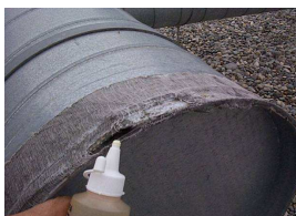
Bouchon non étanche à l'extrémité d'un conduit en toiture terrasse (en outre, l'adhésif est détérioré)
