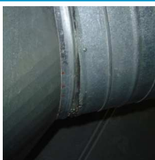
Jonction conduit-coude, avec fuite tout autour de la pièce de raccordement
