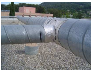
Fuite au niveau du piquage et déchirure (surprenante) à proximité
