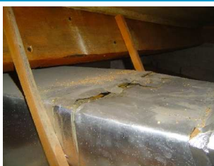
Conduit de soufflage autoportant en combles, avec cassure et fuite importante
