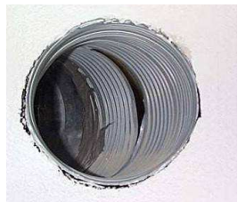
Défaut fréquent sur les conduits de raccordement situés derrière les bouches d'extraction en résidentiel (fuite très importante cumulée sur de nombreuses bouches)
