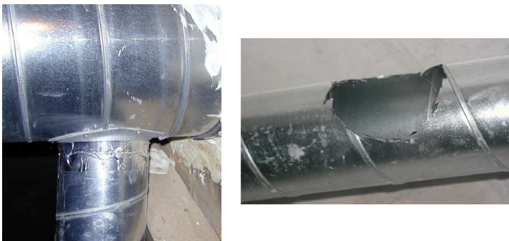
Figure 42 : Exemple de raccord par piquage d'apparence correcte (à gauche), peu soigné (à droite)
