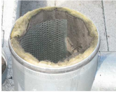
Figure 54 : Intérieur d'un té-souche avec présence de laine minérale
