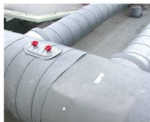
Figure 56 : Exemple d'une trappe de visite non adaptée à la dimension du conduit
