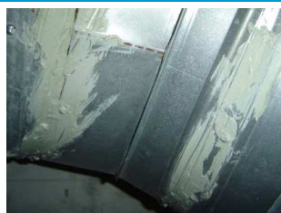
Travail d'étanchéité bâclé au niveau des jonctions avec un coude, fuites notables
