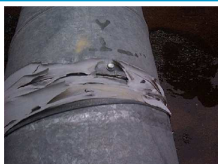
Jonction de deux conduits en toiture terrasse. L'adhésif n'a pas résisté aux conditions extérieures
