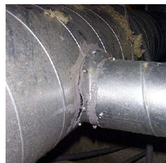
Piquage sur lequel on a forcé pour décaler le conduit (la fuite est importante)
