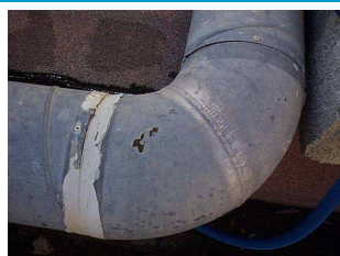
Jonction conduit-coude, avec adhésif ne résistant pas aux conditions extérieures
