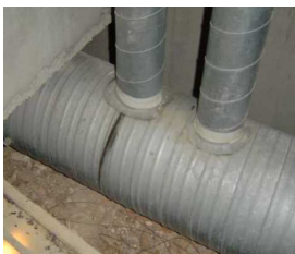
Piquage avec déchirure sur la circonférence du conduit principal
