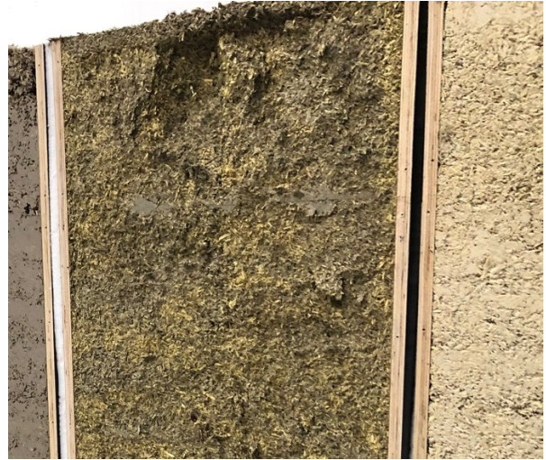
Photo 4 : béton de chanvre non homogène avec décollement ponctuel.
