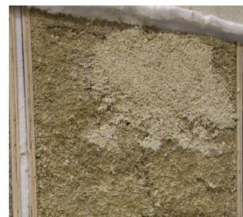
Photo 7 : béton de chanvre en fin de reprise avec rebouchage de la partie décollée.
