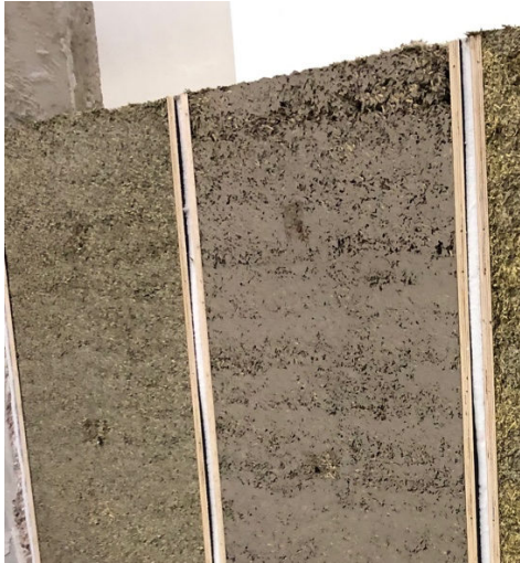
Photo 3 : béton de chanvre homogène sur sa surface.
