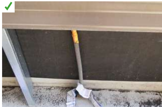
La gaine d'alimentation de l'éclairage extérieur passe ici à travers la dalle béton afin d'éviter les percements des plans d'étanchéités de l'ossature bois. ©AQC
