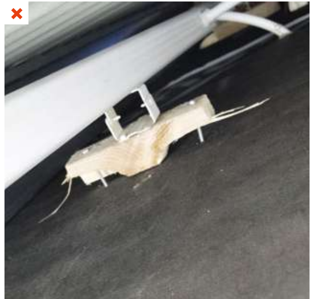
Exemple de détérioration d'une membrane d'étanchéité à l'eau par un opérateur du second œuvre : les pointes servant à fixer les cales qui supportent le réseau électrique percent la pare-pluie. ©AQC
