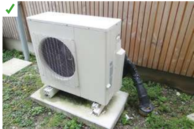
Les réseaux raccordés à cette PAC circulent à travers la dalle afin d'épargner les plans d'étanchéités de l'ossature bois. ©AQC
