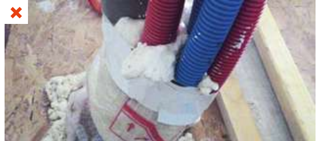
Mauvais traitement de la traversée du plan d'étanchéité à l'air d'un plancher bas. ©AQC
