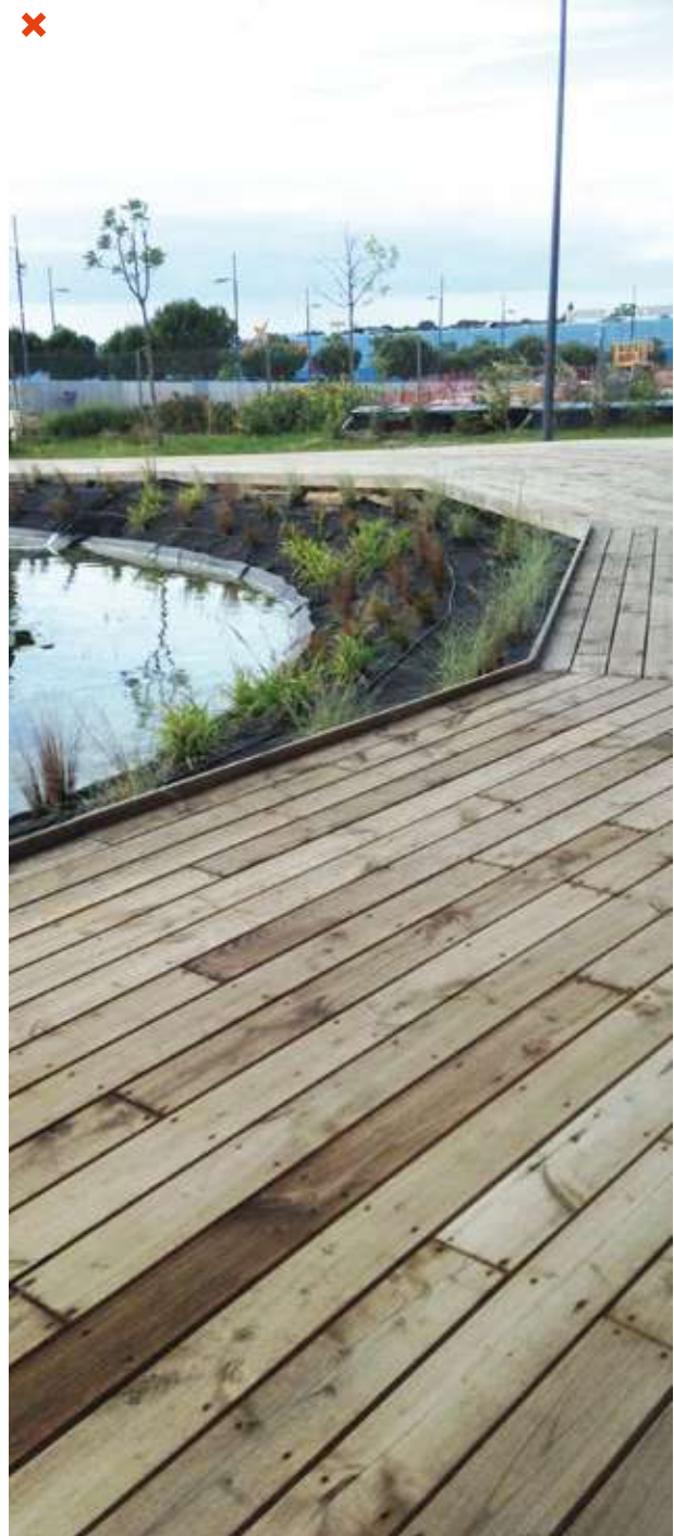
Exemple d'un platelage bois lisse et en pente pouvant devenir glissant.
