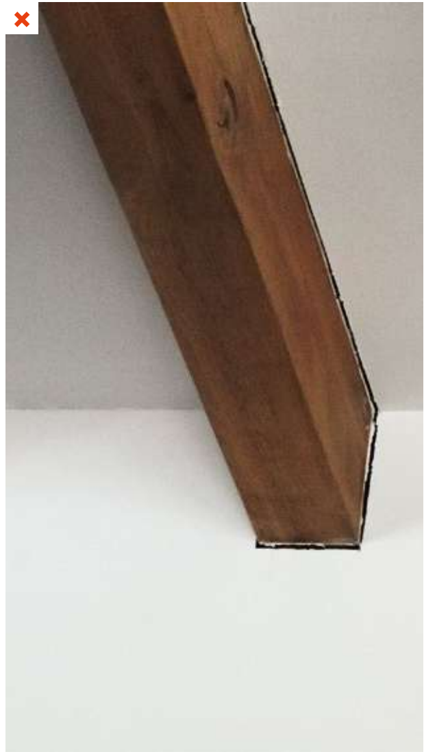
Exemple d'une poutre mise en œuvre avec un taux d'humidité excessif. Elle a subi par la suite un retrait important. ©AQC
