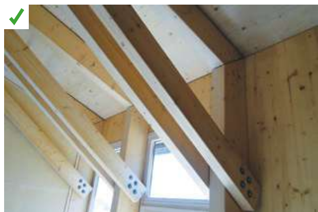
Cette structure poteaux-poutres permet l'installation d'une façade rideau non traversée par des éléments structurels. Cette façade constitue le plan d'étanchéité à l'air dont la continuité est assurée. ©AQC
