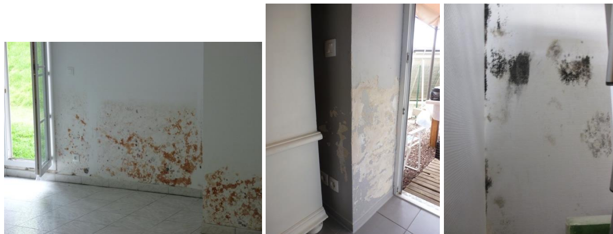
Figure 6 : Apparition de moisissures à la suite de l'isolation de vieux murs. De gauche à droite : moisissures sur mur extérieur, humidité dans les murs par suite de l'installation d'un voile étanche sous le plancher, traces de moisissures dans un mur de refend (sources : AQC).
