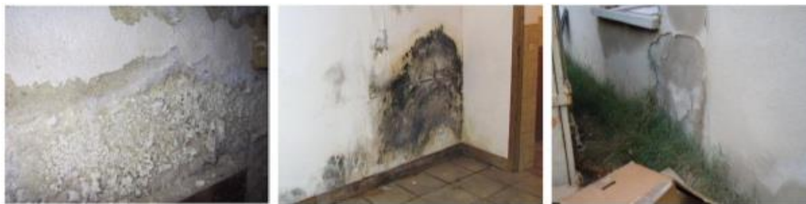
Figure 5 : Pathologies observées après rénovation. De gauche à droite : présence de salpêtre (source : humidites.fr), présence de moisissures sur mur intérieur (source : prix-immobilier.info), trace d'humidité et enduit extérieur dégradé (source : Enertech).
