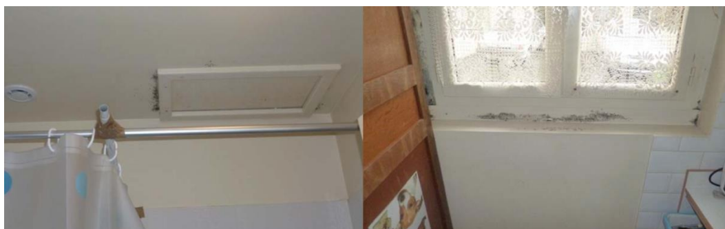
Figure 9 : Exemple de développement de moisissures autour d'une trappe de la salle de bain ainsi qu'en périphérie de la menuiserie extérieure de la cuisine, moins d'un an après rénovation thermique d'un logement avec absence de ventilation (à l'arrêt). Source PUCA ( PUCA, janvier 2013 ).
