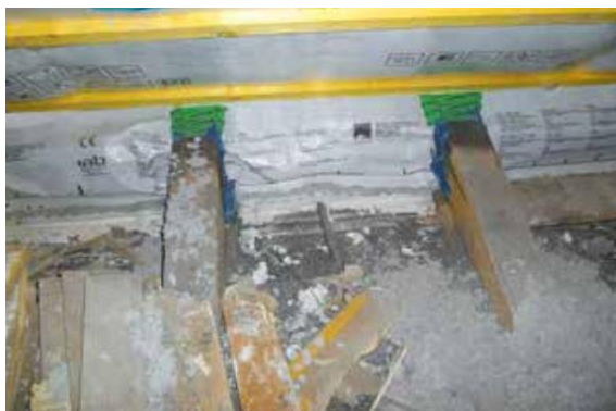
Figure 7 : Phénomène de condensation au niveau des têtes de solives, renforcé par l'absence de ventilation en phase chantier (cas pouvant se produire également dans un logement rénové peu ou non ventilé). Source : AQC ( AQC, Humidité dans la construction, 2019 ).
