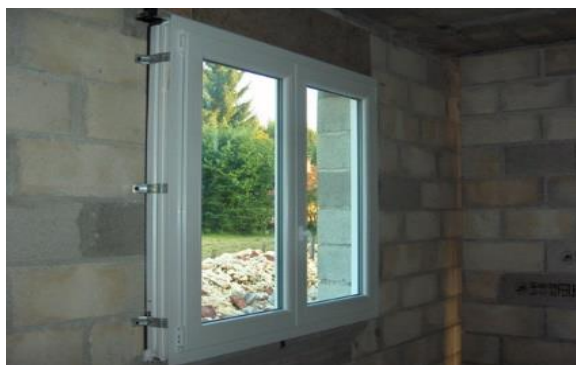
Figure 15 : Fenêtre posée en applique en attente d'une ITI
