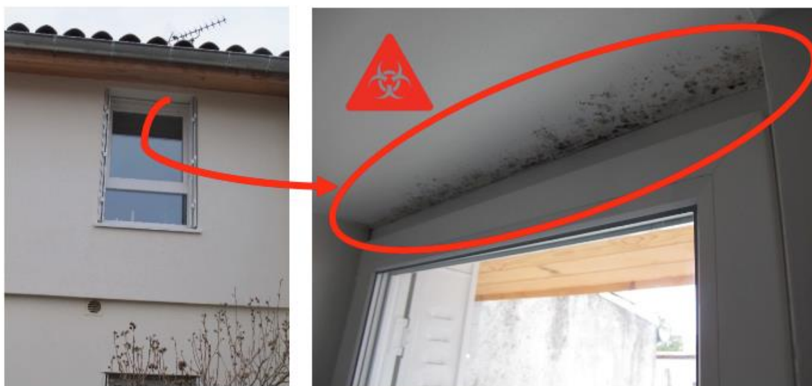
Figure 35 : Moisissures apparues sur un pont thermique dû à la discontinuité de l'ITE et de l'isolation des combles (Source : Dorémi).
