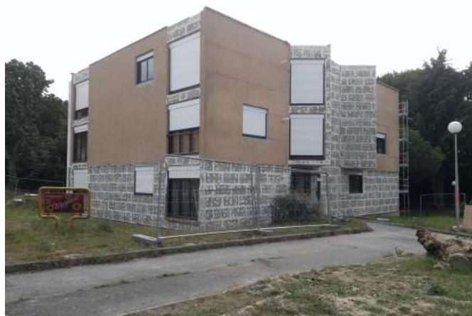
Avant réalisation de l'ITE - ©cohérence
