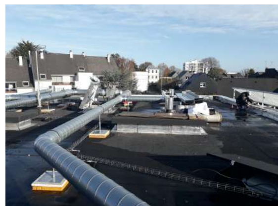
Réseau de ventilation en toiture © cohérence
