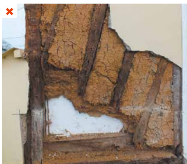
Figure 19 - Pan de bois dégradé : le polystyrène côté intérieur a bloqué le séchage du mur vers l'intérieur Source : Humidité dans la construction, 12 enseignements à connaître, rapport issu du dispositif REx bâtiment performances, ©AQC/CODEM
