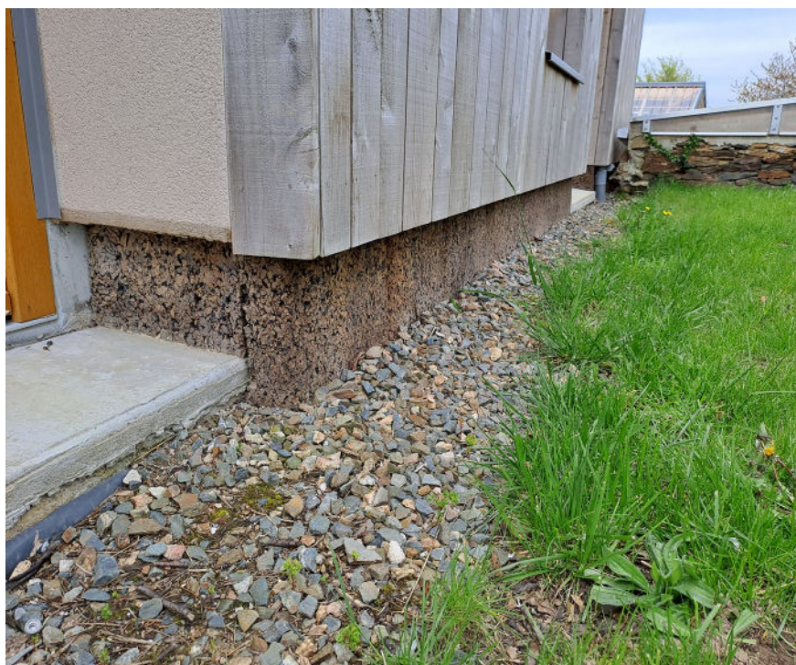
Figure 24 - Photographie du soubassement en liège ©Batylab
